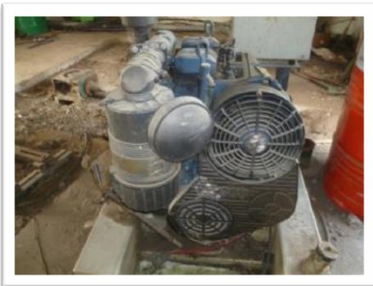
Figure 6 - Mbassis: détail du groupe électrogène
