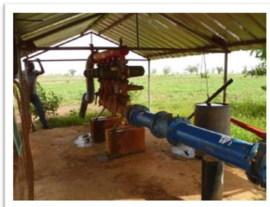
Figure 17 - Ngomène : système de filtrage
