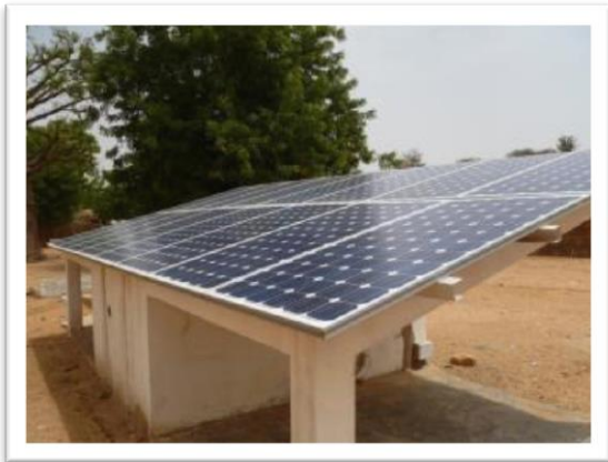
Figure 22 - Périmètres UGPM : panneaux photovoltaïques
