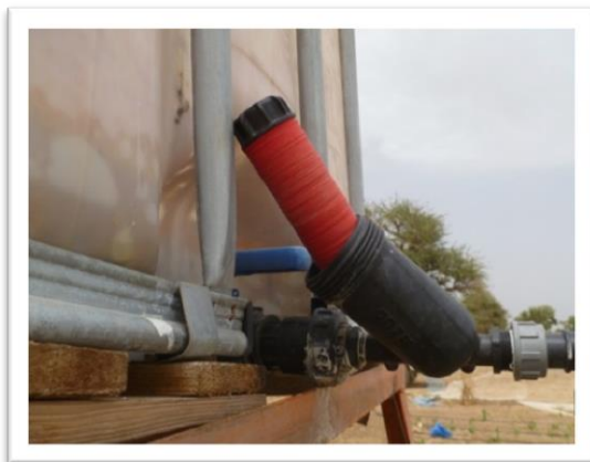
Figure 37 - Mbadiane Gora : filtres au niveau du réservoir
