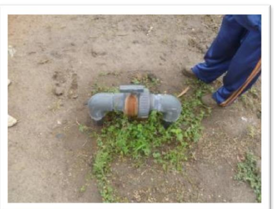
Figure 20 - Ngomène : vannes pour la régulation de la pression
