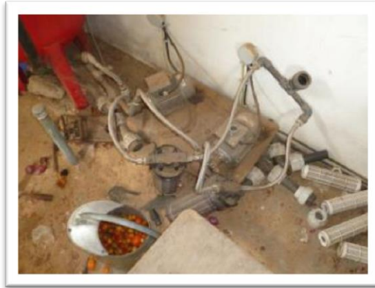
Figure 25 - Périmètres UGPM : pompes électriques
