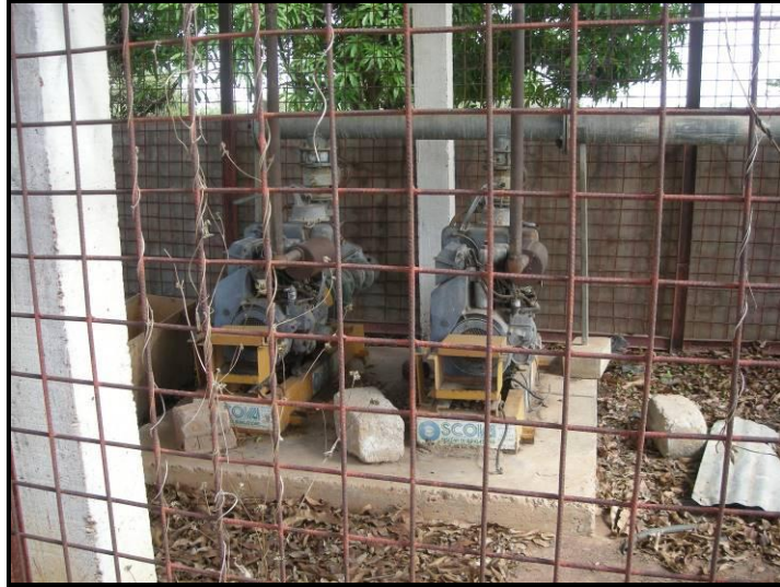
Figure 5. Station de pompage pour l'alimentation du système d'irrigation
